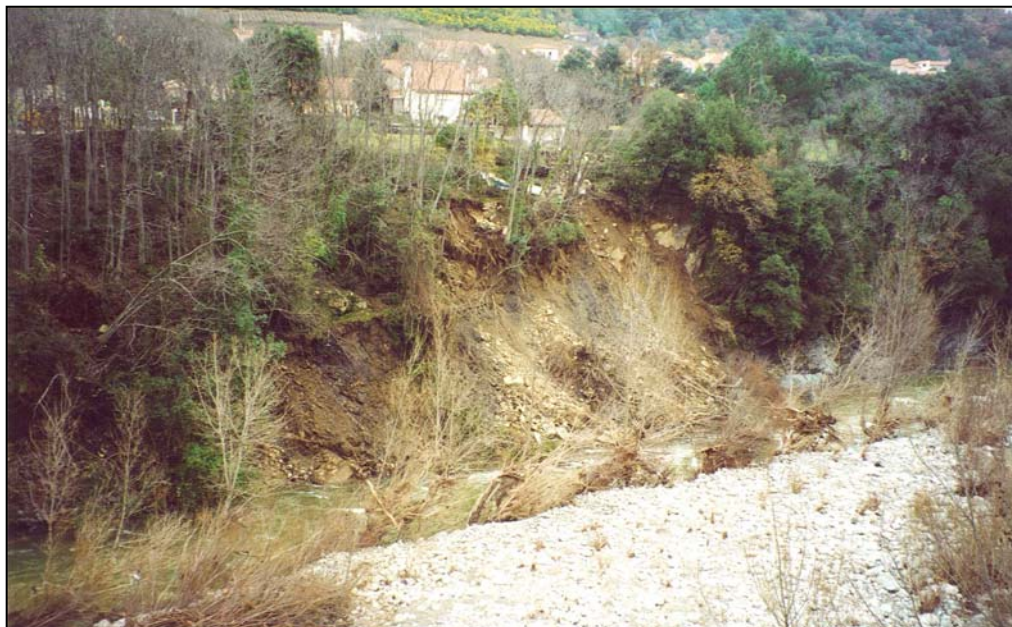
↑ Reynès – effondrement de la partie sommitale de la falaise en rive gauche du Tech, à l'aval du pont menant au hameau du Vila en décembre 2000 Photographies RTM
