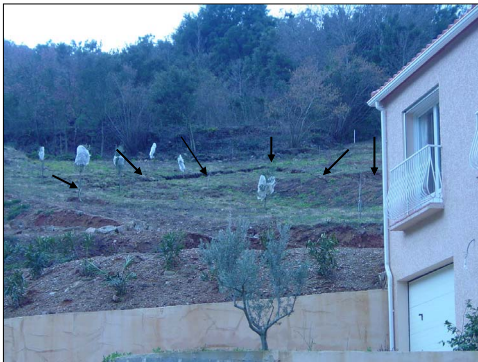
↑ Reynès – Glissement au lotissement « Le Clos de la Forge ». Vue du glissement à l'amont de la maison Photographies RTM
