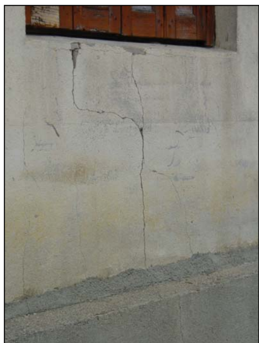
↩ Village de Reynès – Fissures affectant la mairie Photographie RTM 2001
