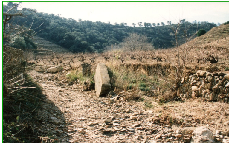
Affaiblissement des berges du Coma-Pascole en amont de la voie SNCF (1991)
