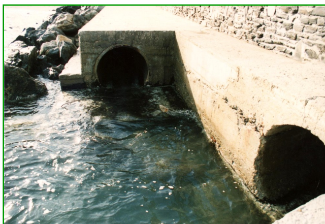
Exutoires des réseaux d'évacuation d'eaux pluviales au niveau de la plage (ici le Mattefoc)
