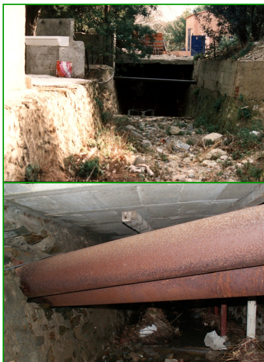
Conduites en travers du canal souterrain du ravin d'Armen, au droit du Centre Hélio- marin
