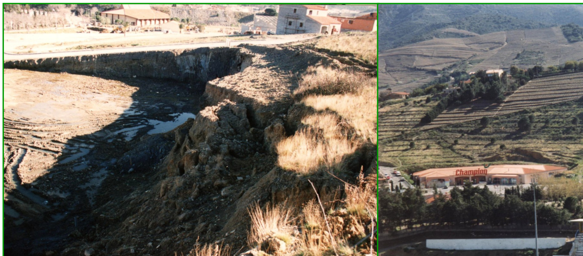
Apparition de désordres dès l'ouverture des terrassements du supermarché en rive droite du canal du Vall Pompo (avant et après implantation du magasin).
