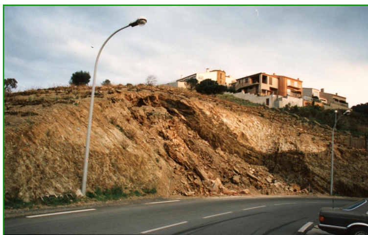
Instabilité d'un front de taille en bordure de la RN 114 en amont du laboratoire ARAGO. (parcelle aujourd'hui construite).
