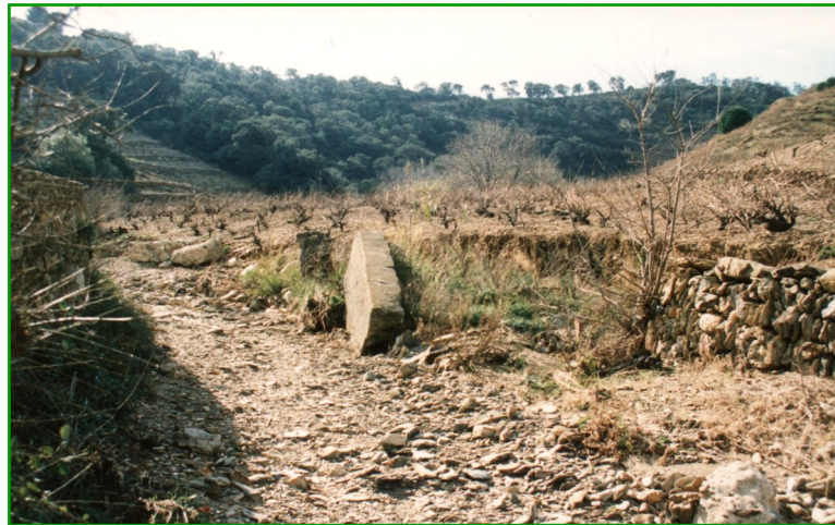
Affouillement des berges du Coma-Pascole en amont de la voie SNCF (1991)
