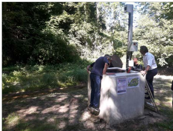
SAINT LAURENT DE CERDANS. Installation d'un Système d'Alerte Local au droit du camping (RTM, 2022)
