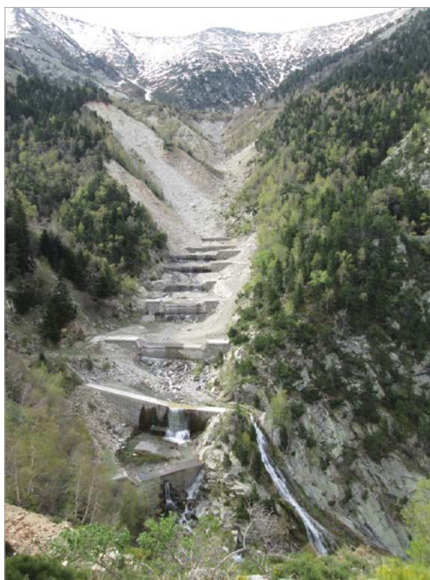
VERNET-LES-BAINS. Dispositif de correction torrentielle des Conques du Canigou pour fixer la moraine et éviter des crues trop chargées de matériaux solides du torrent du St Vicent (RTM)
