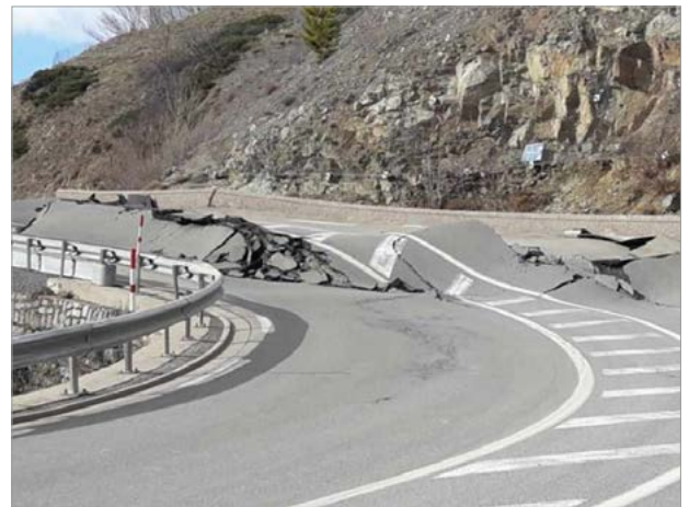
RN116. Glissement de terrain de versant d'un volume estimé à 500 000 m 3 déclenché sur les pentes du Pallat entre Fontpédrouse et Sauto soulevant la chaussée de la RN116 qui resta fermée plus de 3 mois. RTM
