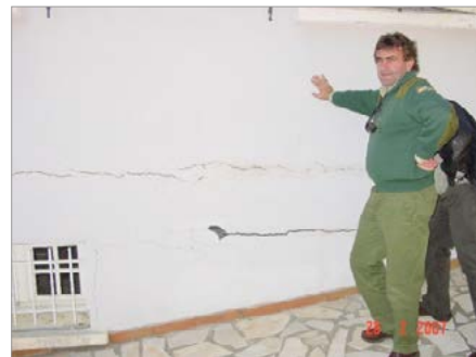
Reynès. Fissuration d'une maison d'habitation à cause du retrait/gonflement des argiles (RTM, 2007)
