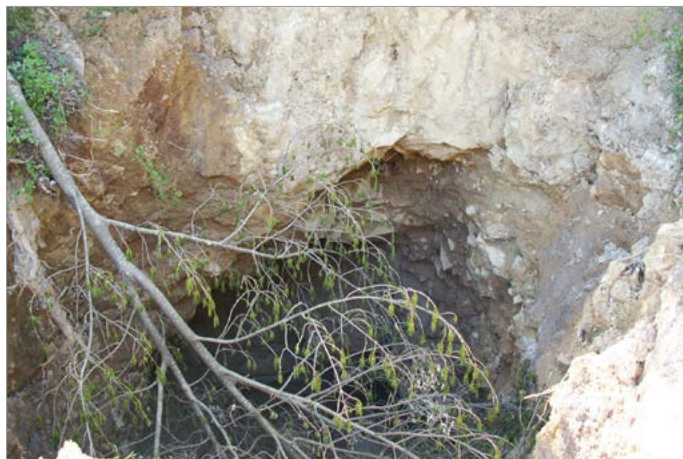
Reynès. Effondrement en 2017 du toit d'une cavité d'origine minière (RTM, 2007)
