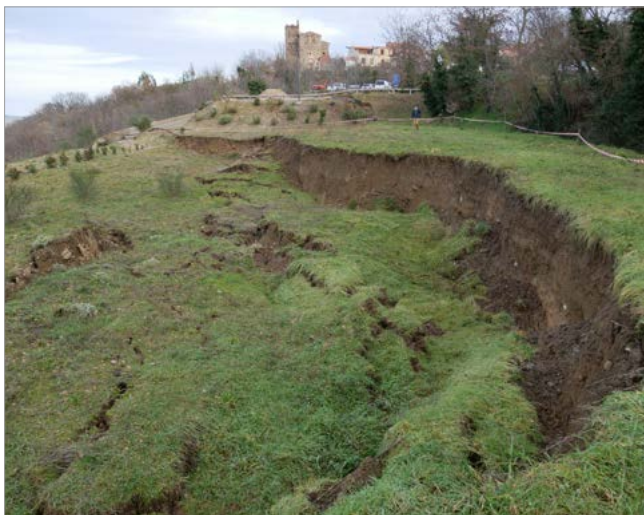
Ria-Sirach. Glissement de terrain de 200 000 m 3 déclenché à la suite de la tempête GLORIA de janvier 2020 et impactant la ligne SNCF entre Prades et Villefranche-de-Conflent. RTM
