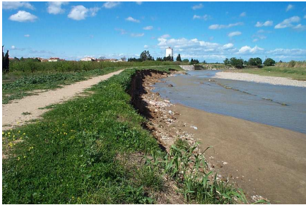
Saleilles – Réart (glissement du talus de digue côté cours d'eau)
