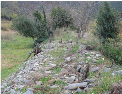
Digue constituée au fil du temps
